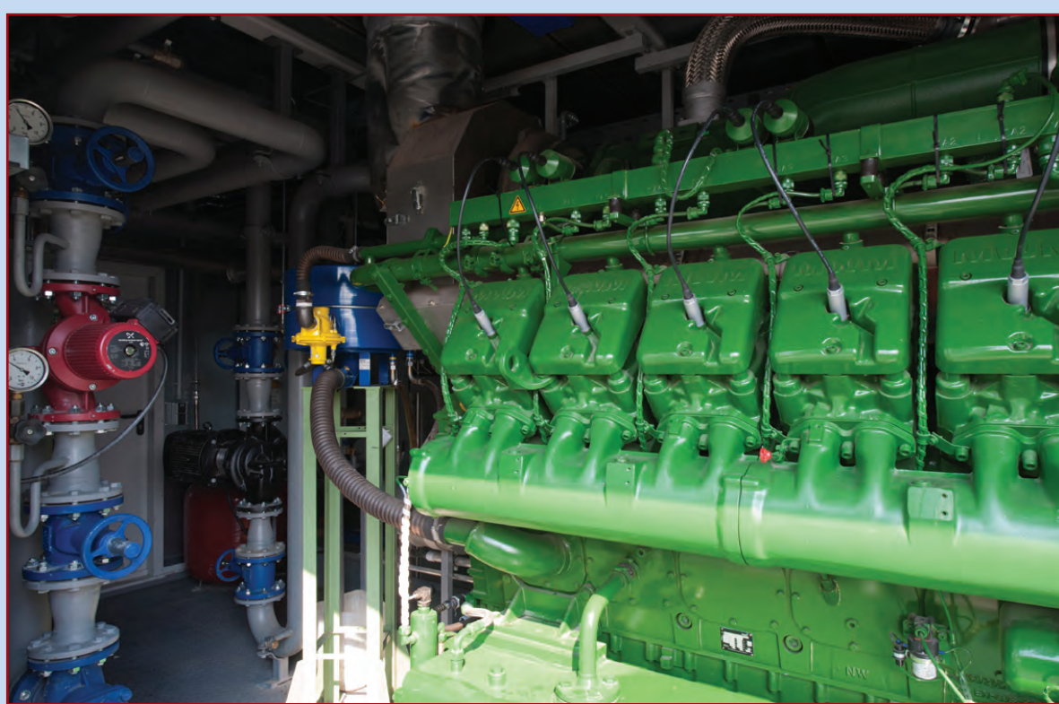
Gasmotor der Biogasanlage, Bild von RheinEnergie Biokraft Randkanal-Nord GmbH & Co.KG; Aufnahme vom 26. Juli 2012
