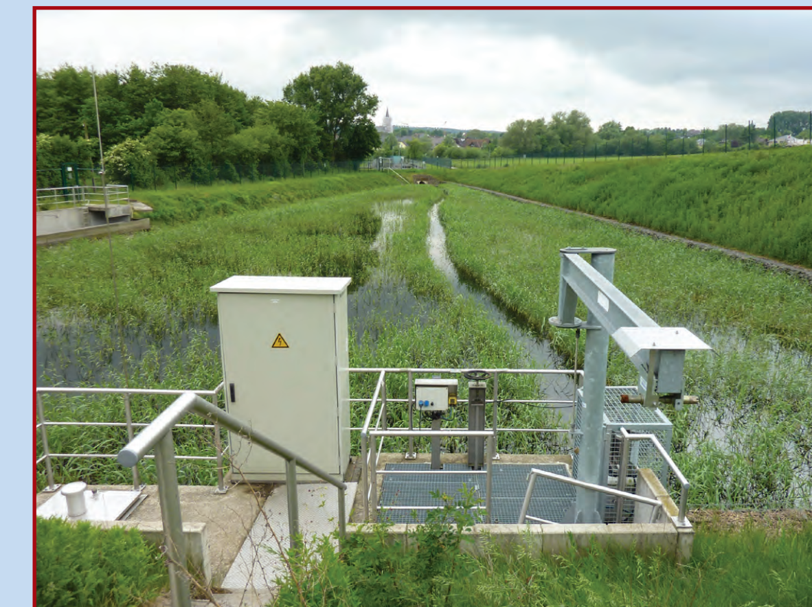
Retentionsbodenfilter Klärwerk Glessen; Im Hintergrund Regenüberlaufbecken Aufnahme vom 31. Mai 2010
