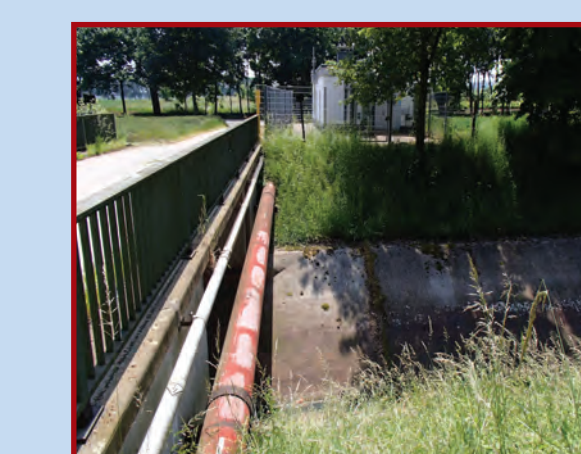
Erdgas-Übernahmestation GVG; Aufnahme vom 11. Juni 2013
