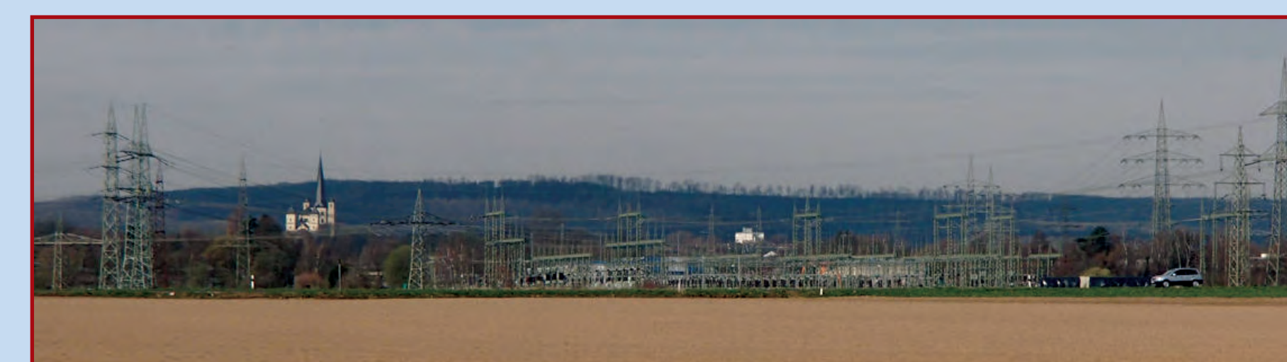
Umspannwerk Brauweiler vom Randkanal aus aufgenommen; 15. April 2013
